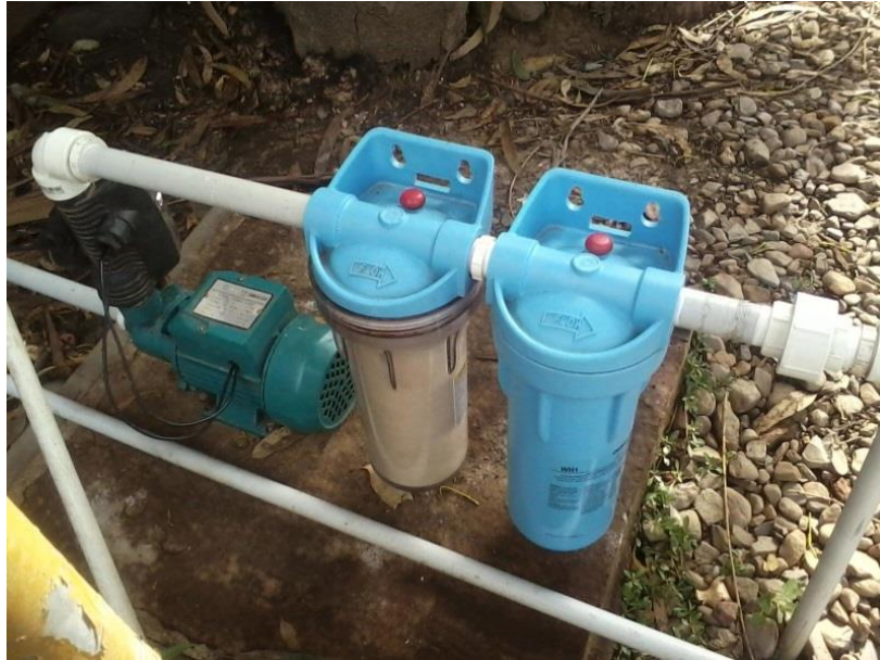
Figura 2 - Bomba de ½ hp provista de presostato de señal eléctrica y filtros comerciales.
