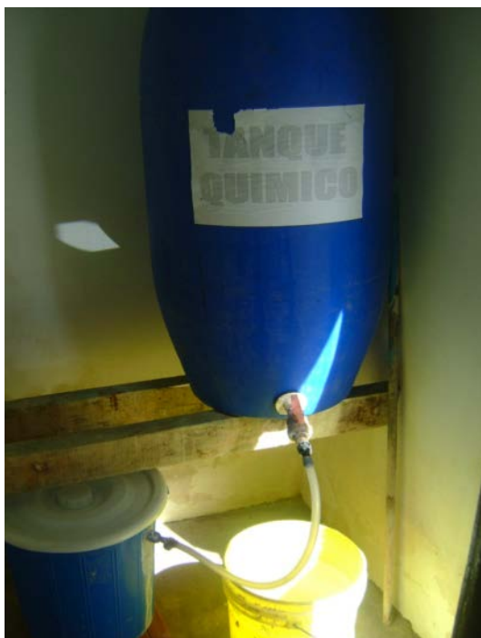
Fotografía 2 Hipoclorador del sistema de agua potable de Cotabuma
