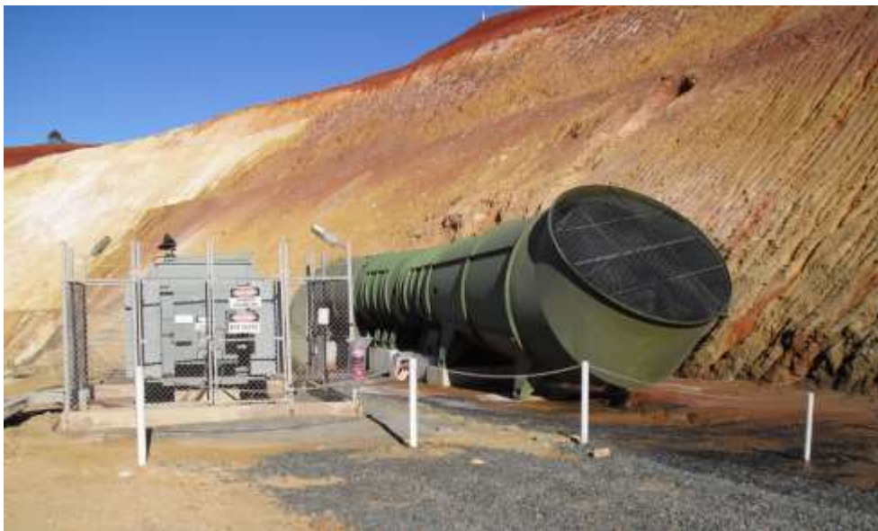
Figura 1. Ventilador Primario de 1500 kW Instalado como Extractor de Aire
