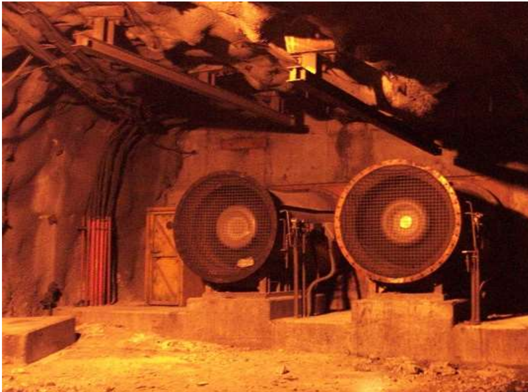
Figura 2. Dos Ventiladores Secundarios de 400 kW en un Muro de Concreto (Lado de Entrada)
