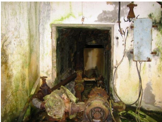
Figura 22. Estado actual de la bocamina 375
